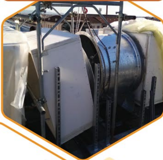
Rivestimento Ventole di Estrazione
