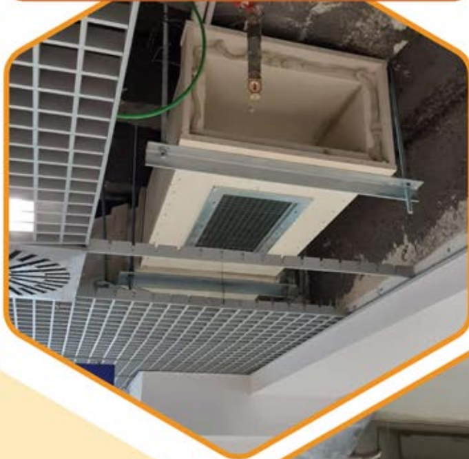
Condotta con Presa d'aria
