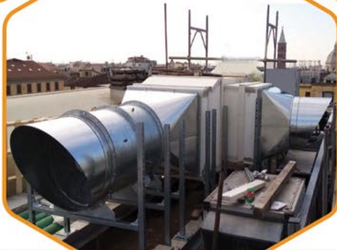
Raccordo Incrociato per Sbocco Estrazione su Tetto
